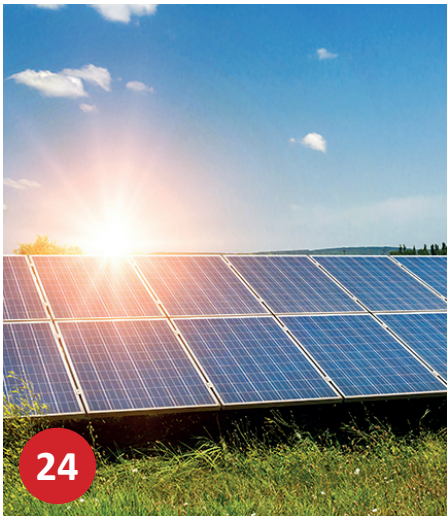
Painel de energia solar
